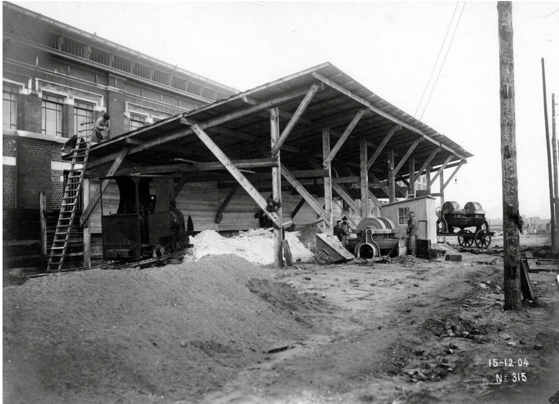
Installaties voor het elektrisch malen van mortel.
