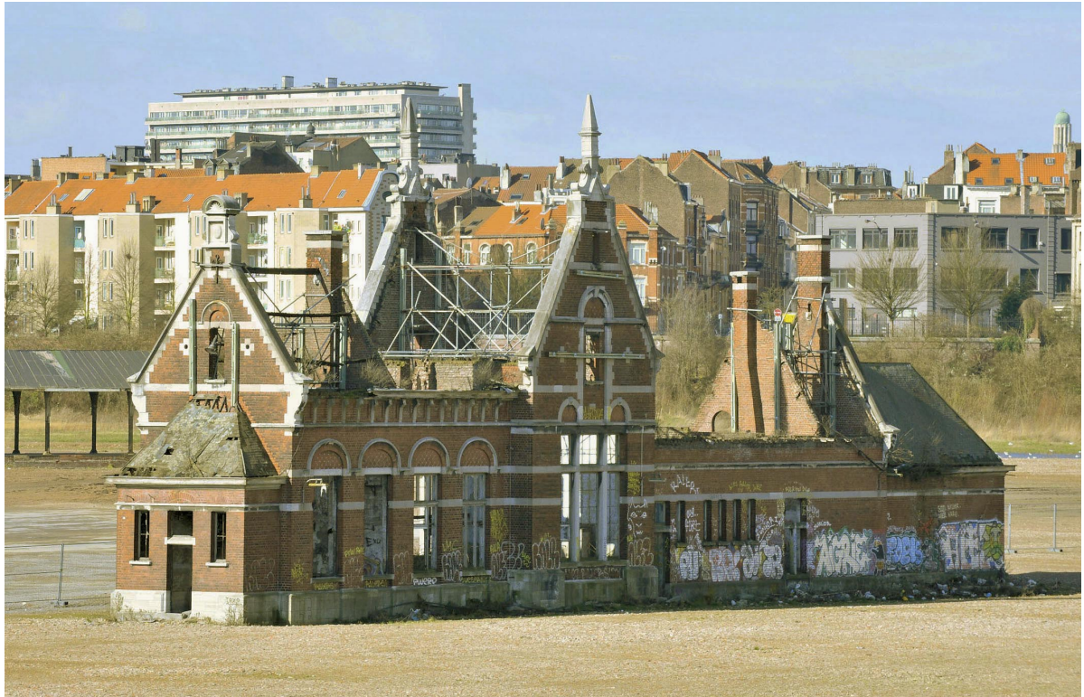
Het dienststation of sorteerstation, zwaar beschadigd na een brand in de jaren 1990.
